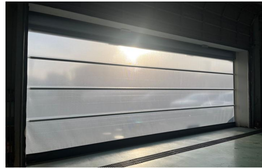
【工場内側から閉めた状態】
